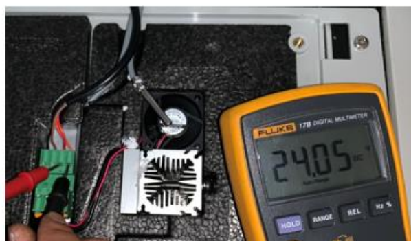
■ 右边2个端子为风扇的供电DC24V
